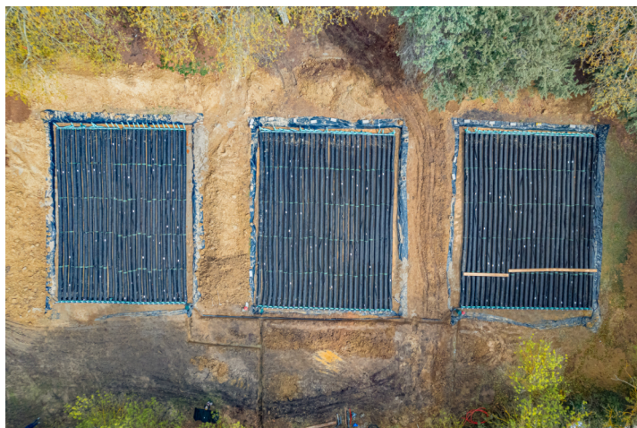
Vue aérienne sur les 3 filtres Enviro))Septic
