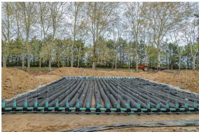
Test du système de répartition sous faible pression
