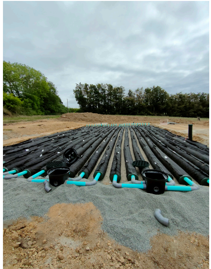
Travaux de mise en œuvre de l'EnviroSeptic - Raccordement des regards de répartition
